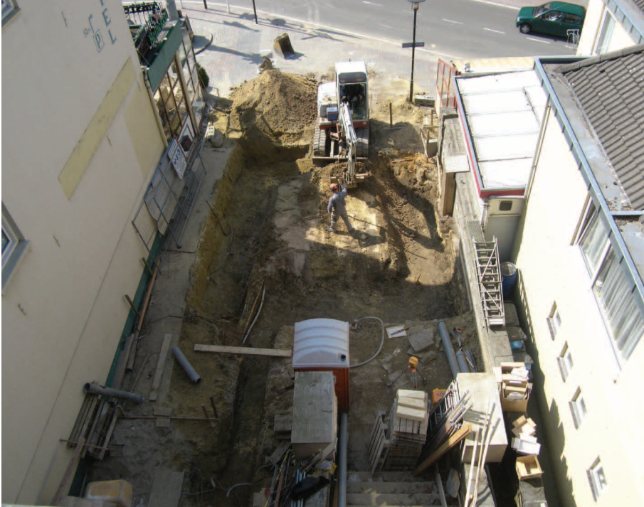
Afbeelding 2.14 Het uitgraven van de funderingsleuf ten behoeve van het entreegebouw in de Kasteelsteeg is archeologisch begeleid.
